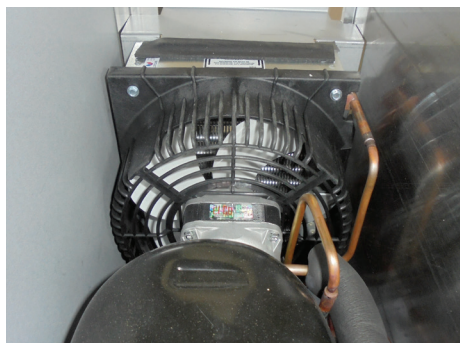
ENTRETIEN DU VENTILATEUR DU CONDENSEUR
